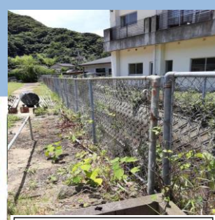
⑧小学校跡 フェンス老朽化のため登る揺らす危険
